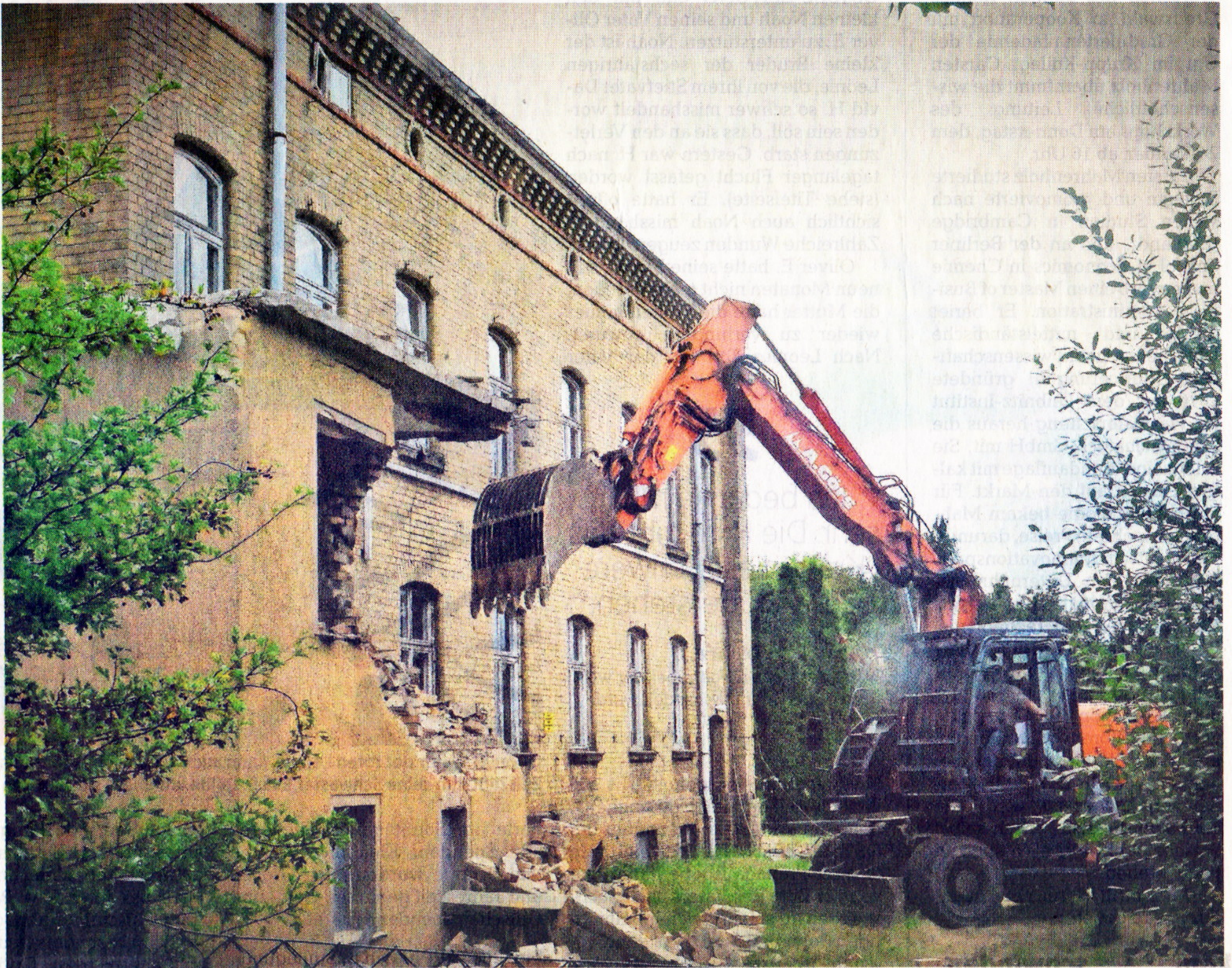
Das ehemalige Institut in der Hainstraße in Eldena wurde im vergangenen Jahr abgerissen.
